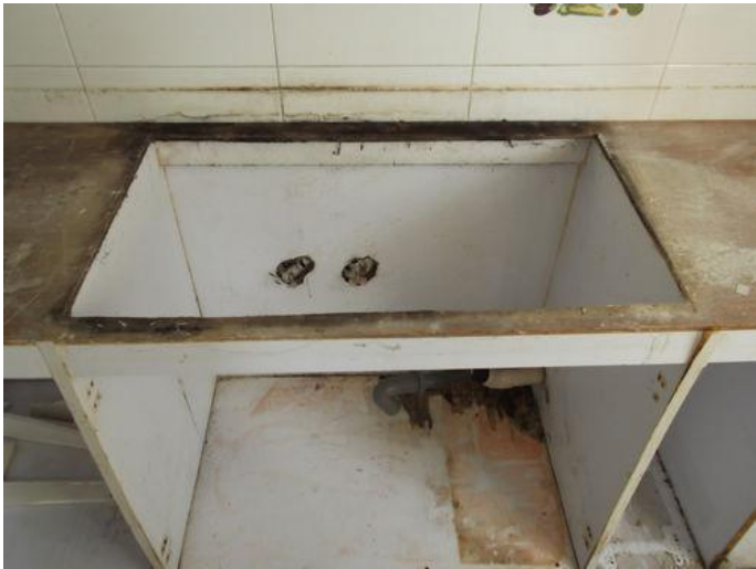
▲板材受潮只能换新
